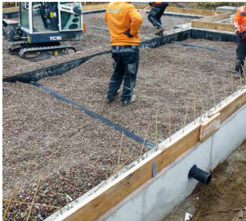
Durchführung der Gasdränage durch das Ringfundament und Verteilung des Filterkieses im Ringraum
