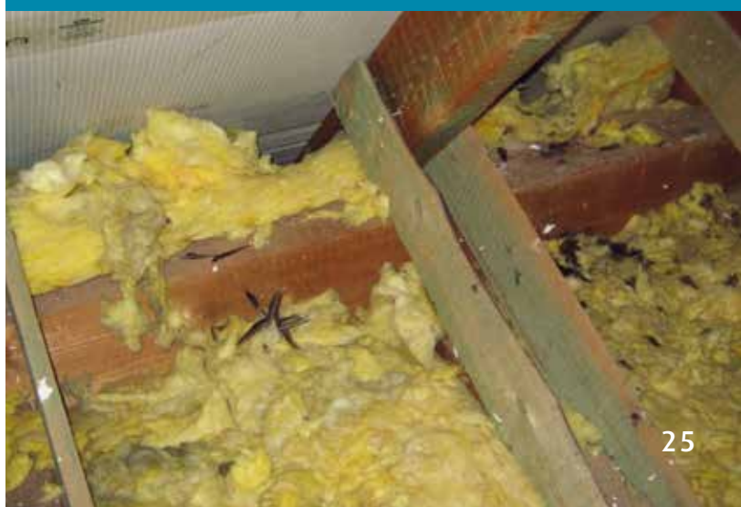
Marderspuren auf dem Dachboden
